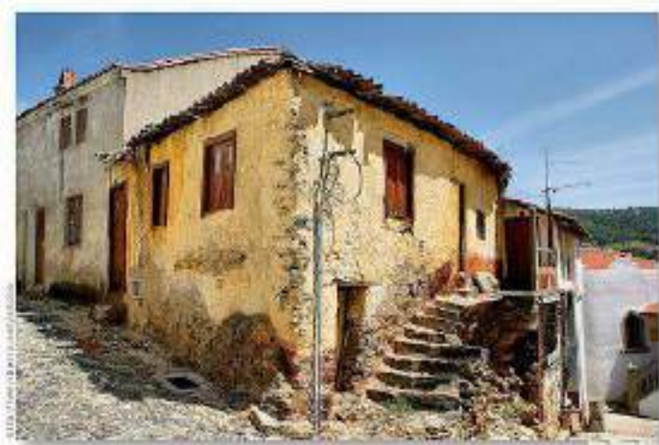
Figura 3.9 - Dano nível moderado (Fonte: Víctor Ribeiro, 2009. Disponível em: < https://www.flickr.com >. Acesso em: 07 mai. 2017)
