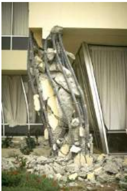
Figura 3.15 – Deformação das estruturas de sustentação (Fonte: Engenhariacivil.com, 2011. Disponível em: < https://www.engenhariacivil.com >. Acesso em 15 mai. 2017)
