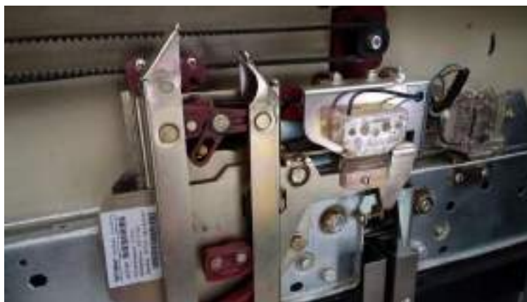
Figura 3.12 – Tranca da porta da cabine do elevador travada (Fonte: Comissão)
