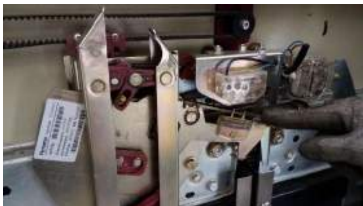
Figura 3.13 – Tranca da porta da cabine do elevador destravada (Fonte: Comissão)
