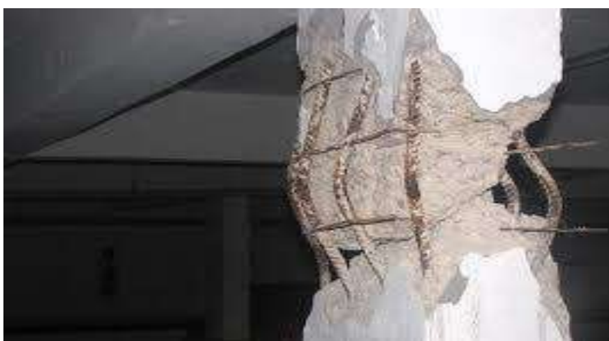
Figura 3.6 – Exemplo de dano estrutural (Fonte: Ministério Público do Pará, 2011. Disponível em: < http://www.mp.pa.gov.br >. Acesso em: 28 mai. 2017)
