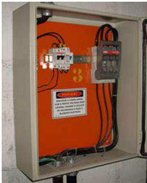
Figura 2.9 – Quadro de força (Fonte: Comissão)
