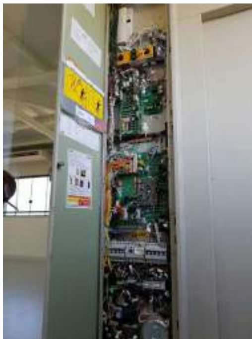
Figura 3.8 – Vista do painel eletrônico do elevador ao lado da porta (Fonte: Comissão)
