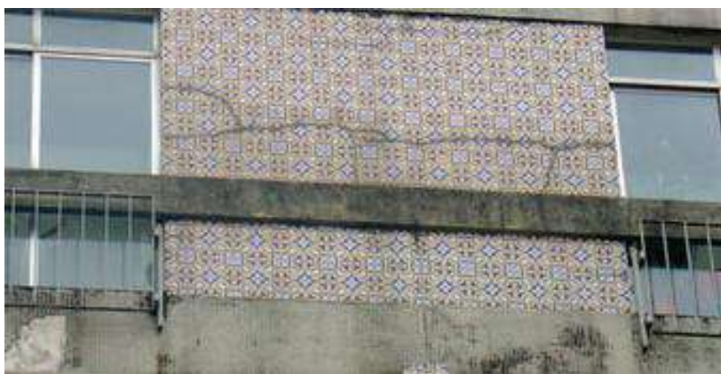
Figura 3.7 - Exemplo de dano não-estrutural (Fonte: Weber Saint-Gobain. Disponível em: < https://www.weber.com.pt >. Acesso em: 12 abr. 2017)
