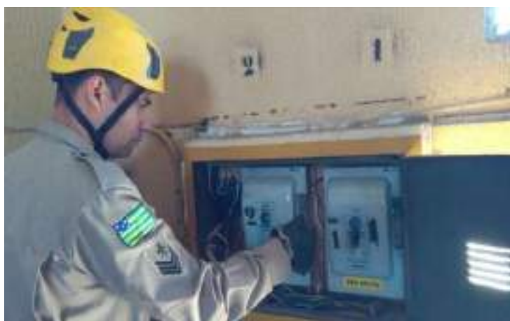
Figura 3.1 – Desligando chave geral do elevador (Fonte: Comissão)
